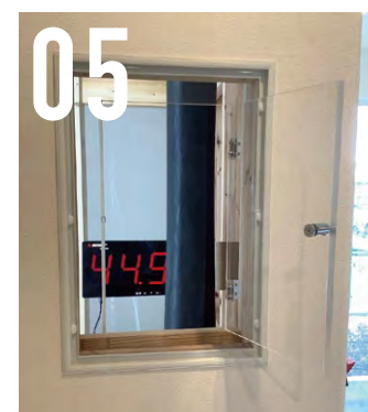
05 排水管／音消しカバー
