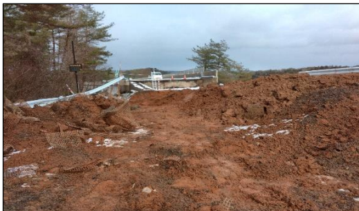
1月28日現場状況「のと里山海道」（越の原IC～穴水IC間）
