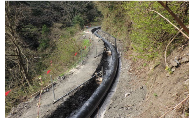
小水力発電送水管
