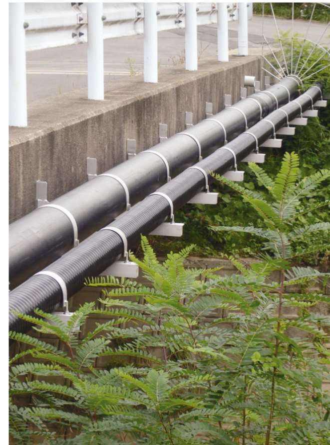
上下水道ダブル配管
