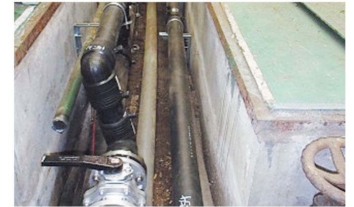
圧縮エア配管
