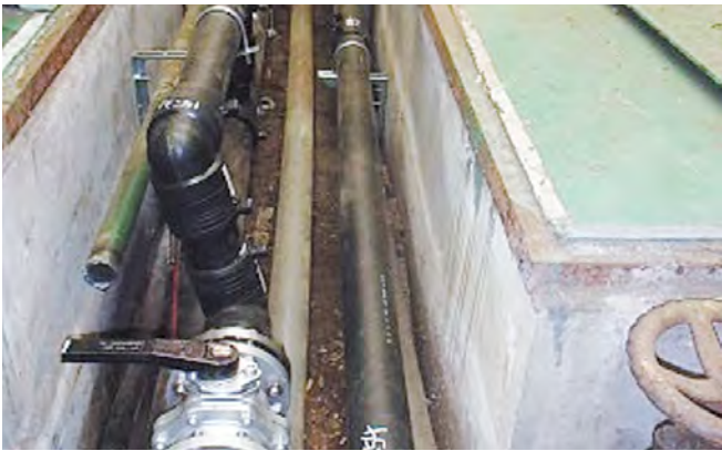
圧縮エアー配管
