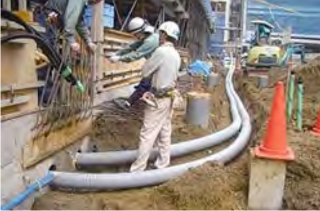
地域冷暖房配管
