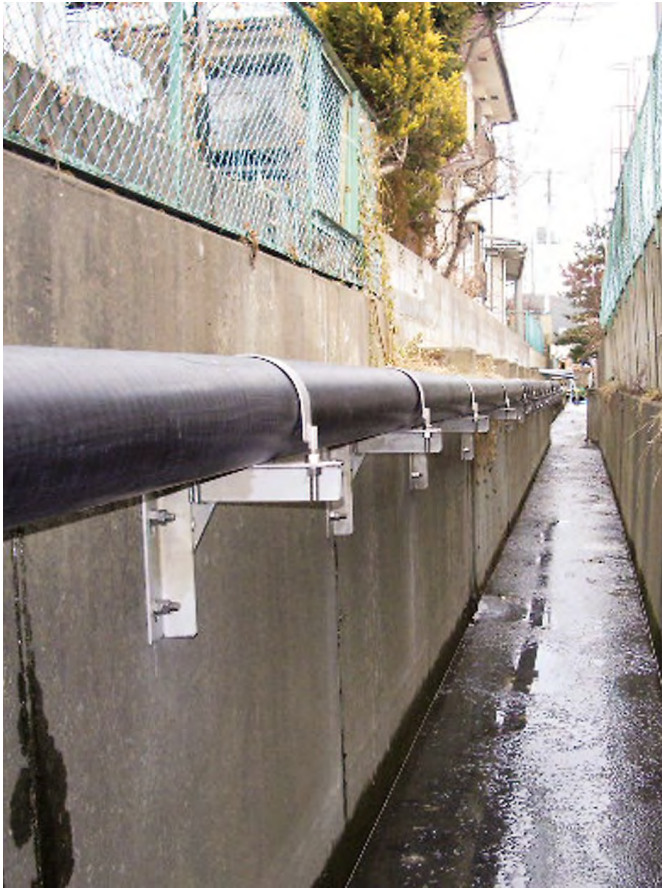
用水路側壁配管
