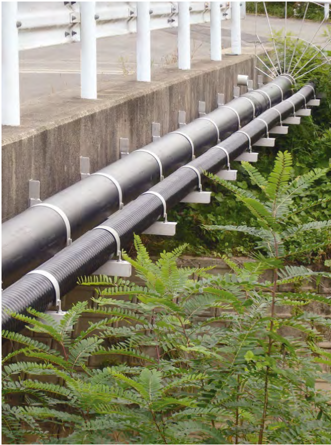
上下水道ダブル配管
