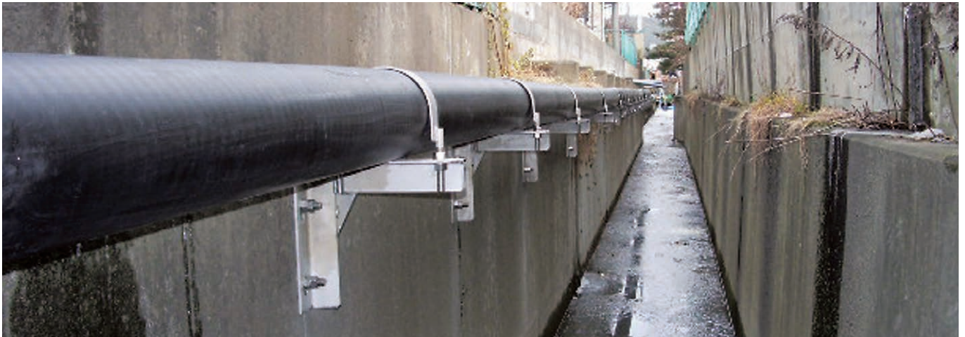
用水路側壁配管
