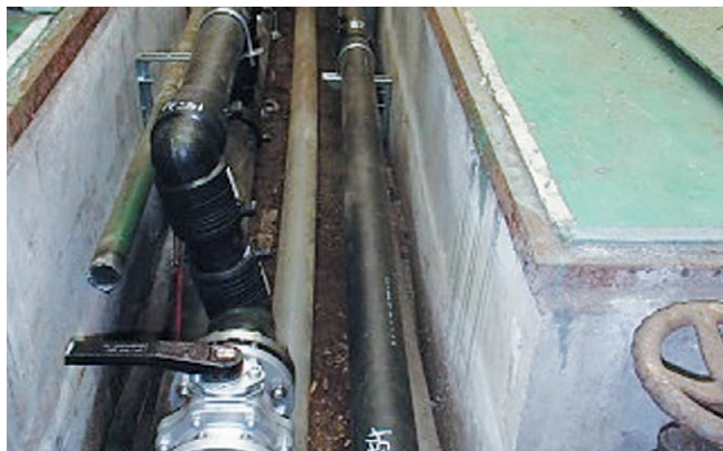
圧縮エア配管
