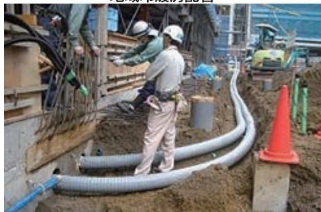
地域冷暖房配管
