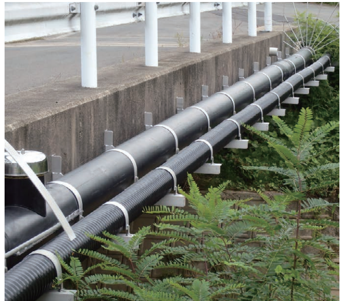
上下水道ダブル配管
